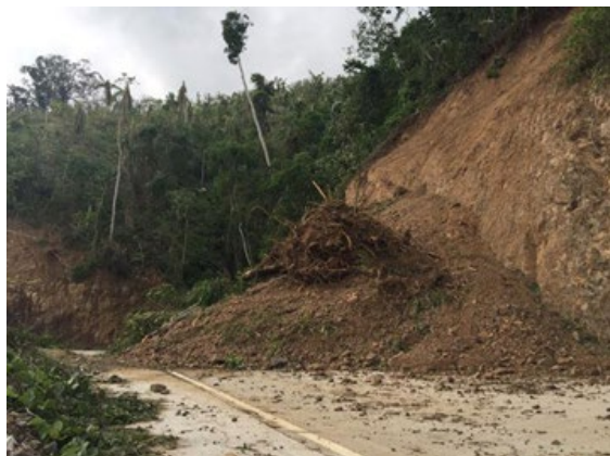
Figure 1 : Exemple d'un glissement de terrain ayant eu lieu sur la route.
